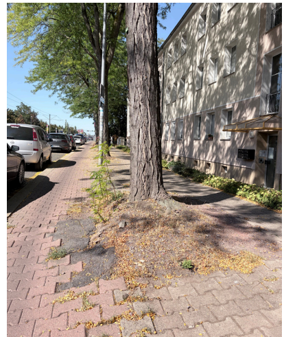
Das in Betonringe gesperrte Wurzelwerk der Bäume entlang des Südrings bahnt sich seinen Weg nach oben und hebt dabei die Geh- und Radwegplatten an.
